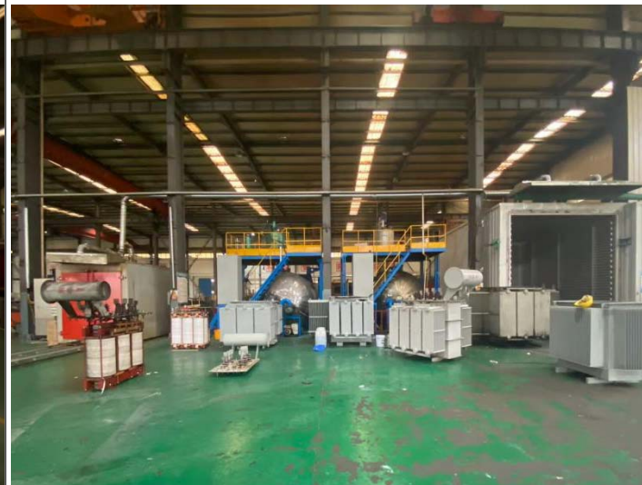
变压器机芯干燥箱、环氧树脂浇注设备及废气收集措施
