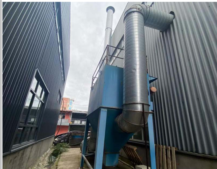
焊接工序袋式除尘器
