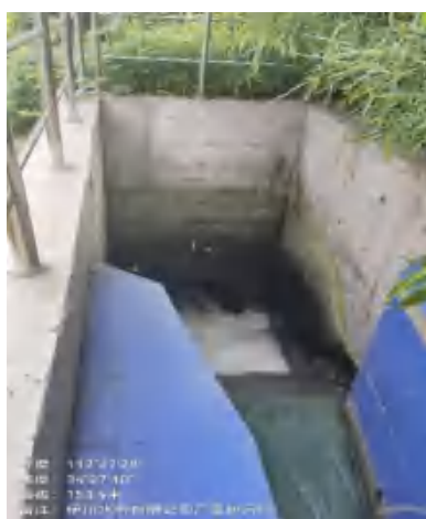
污水处理厂厂区内废水总排放口
