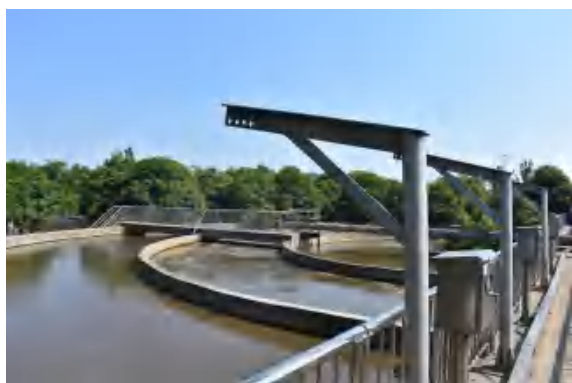
现有工程一期工程二沉池
