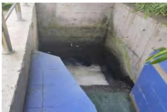
污水处理厂厂区内废水总排放口
