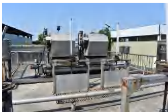
现有工程二期工程粗格栅
